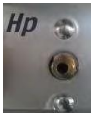
Рис 9 б– Разъемы и краны низкого и высокого давления
